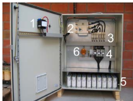
Figuur 7: Condensatorbatterij (bron: Wikipedia) met '5' de condensatoren
